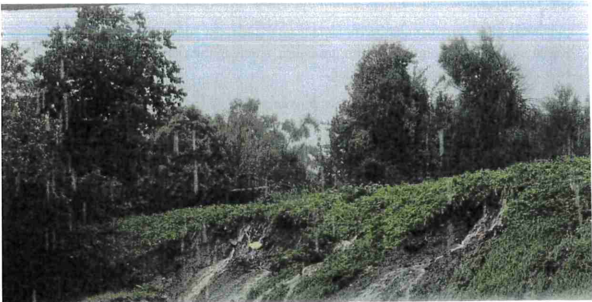
Effondrement des terres, talus sud propriété de la Pépinière
