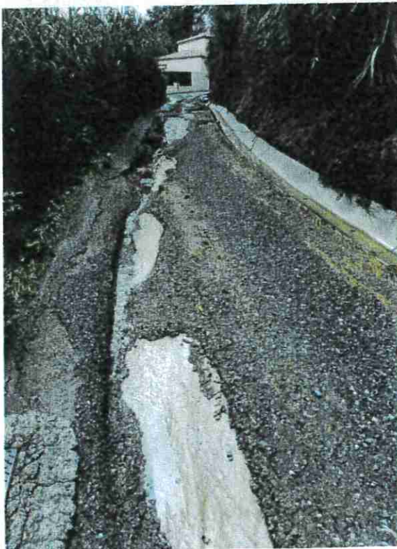
Dégâts après sinistre
