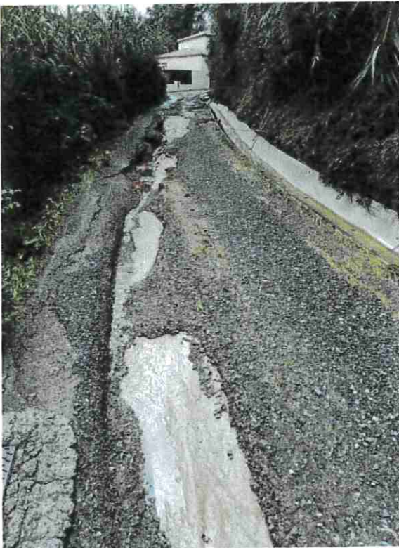
Dégâts après sinistre
